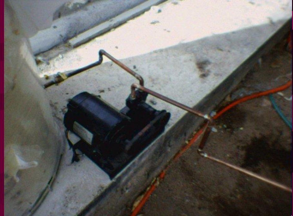
Figura 15.- Bomba hidráulica colocada a la entrada y salida de los colectores solares.
