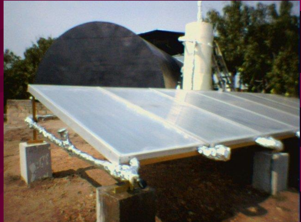
Figura 14.- Sistema de calentamiento del aceite y bombeo del banco de colectores solares planos
