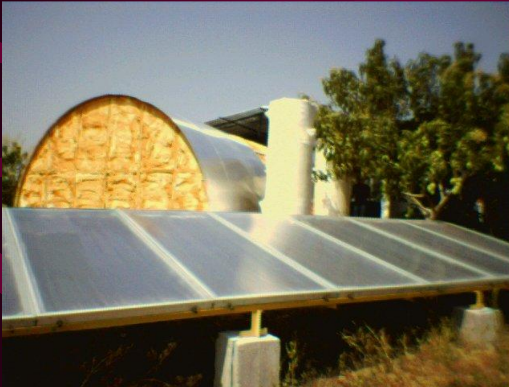
Figura 13.- Banco de colectores solares planos
