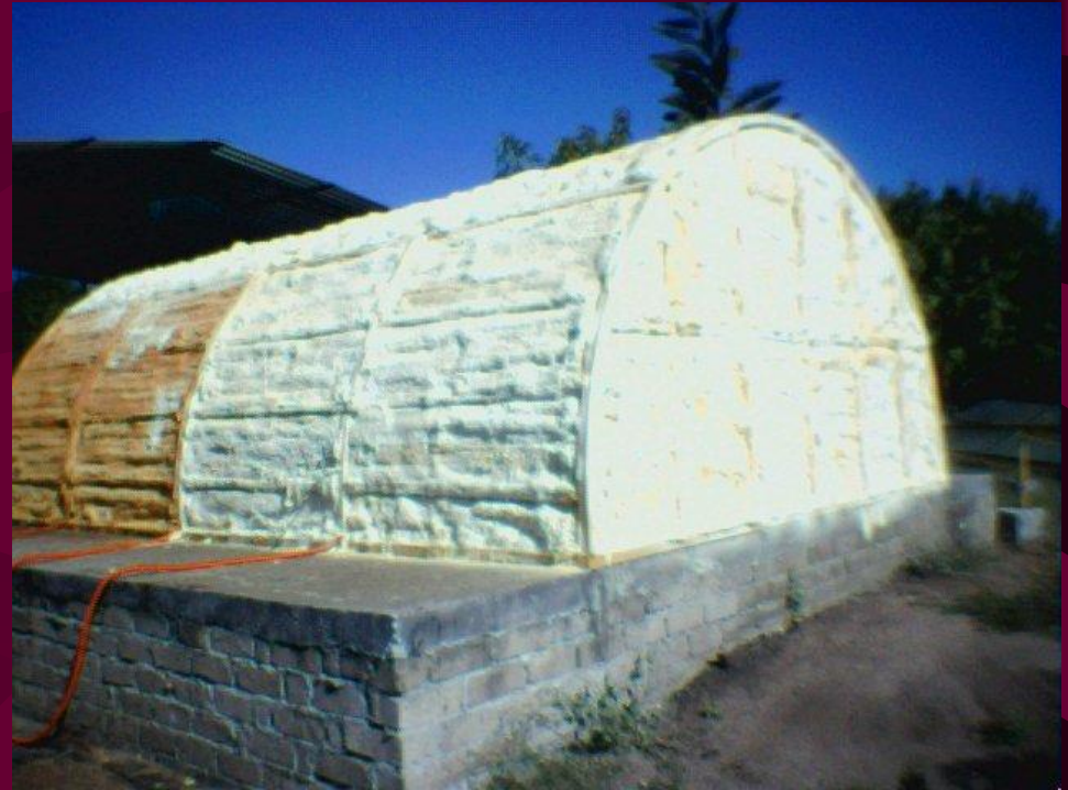
Figura 7.- Recubrimiento de aislamiento térmico de la cámara de secado.
